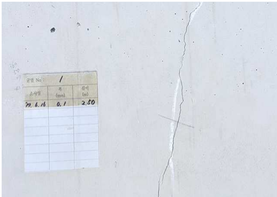
STA 0+725 ~ 0+790 벽체 콘크리트 균열 현황 (총 14개소)
