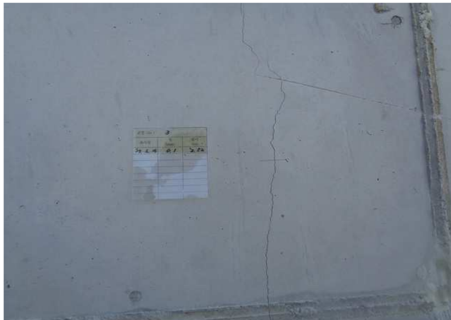
STA 0+725 ~ 0+790 벽체 콘크리트 균열 현황 (총 14개소)
