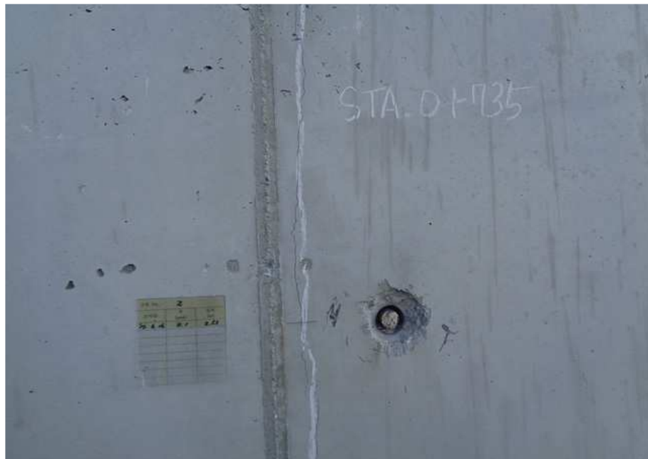
STA 0+725 ~ 0+790 벽체 콘크리트 균열 현황 (총 14개소)
