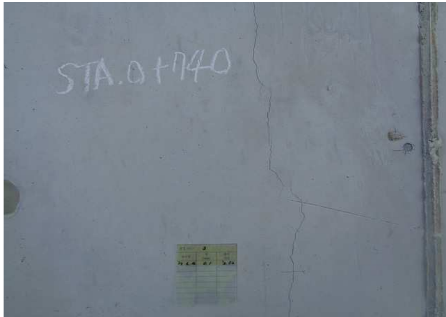
STA 0+725 ~ 0+790 벽체 콘크리트 균열 현황 (총 14개소)
