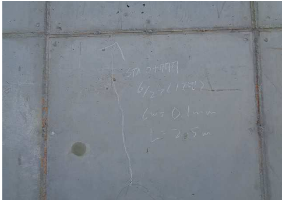
STA 0+725 ~ 0+790 벽체 콘크리트 균열 현황 (총 14개소)
