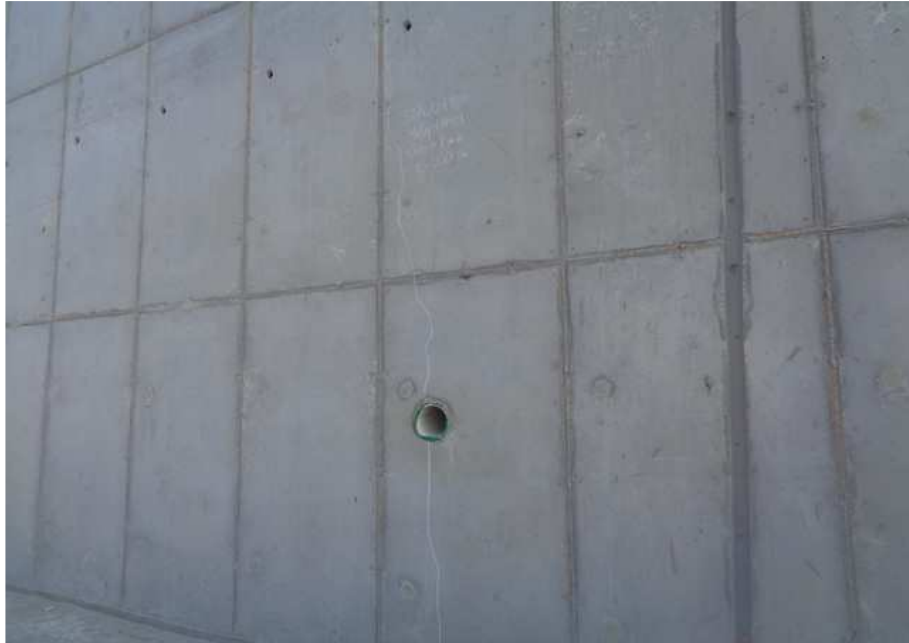
STA 0+725 ~ 0+790 벽체 콘크리트 균열 현황 (총 14개소)
