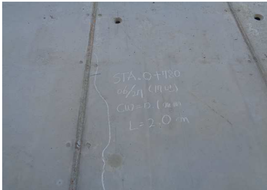
STA 0+725 ~ 0+790 벽체 콘크리트 균열 현황 (총 14개소)
